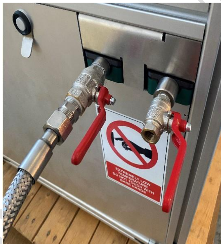
Vanne d'alimentation CO 2 à gauche, vanne de dépressurisation à droite.
